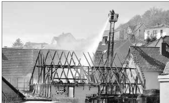
Über die Drehleiter der Heyeröder Feuerwehr bringt ein Löschtrupp den Brand unter Kontrolle.
