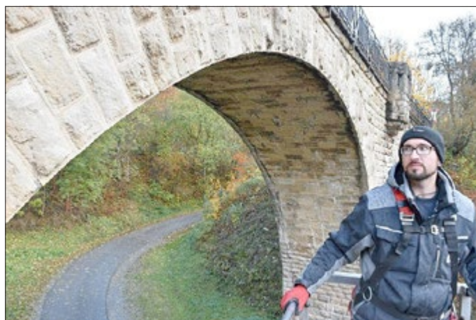
Tino Krahl von der Firma Denkmalpflege Mühlhausen Huschenbeth besieht sich die Schäden an der alten Heyeröder Bahnbrücke
